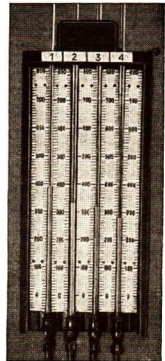
Abb. 151. Flüssigkeitsmanometer in einem Gaswerk
