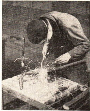
201/2 Flugbahnen von Funken beim Schweißen. Die glühenden Teilchen werden unter verschiedenen Winkeln weggeschleudert
