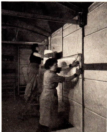
Abb. 114 Kühlwagen werden mit Piathermplatten ausgekleidet, die zum Schutz gegen Feuchtigkeit mit Perfol eingeschlagen sind
