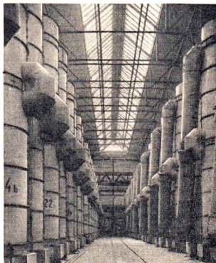
Abb. 50 Die Kohlenmonoxyd-Konvertierung des VEB Leuna-Werke „Walter Ulbricht“ nach dem Wiederaufbau
