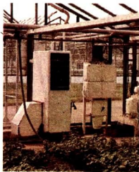
Klimaanlage eines Gewächshauses
