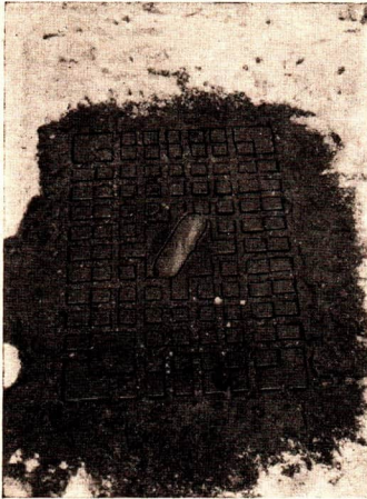
Abb. 10. Auch bei Schnee- und Frostwetter muß der Hydrant für die Feuerwehr jederzeit sofort zugänglich sein. Um Eisbildung auf dem Deckel zu verhindern oder vorhandenes Eis aufzutauen, wird Tausalz gestreut.
