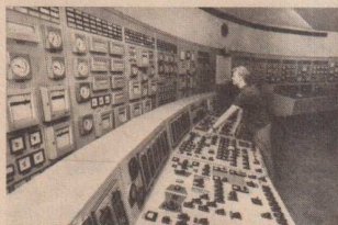
59/1 Blockwarte in einem Kraftwerk
