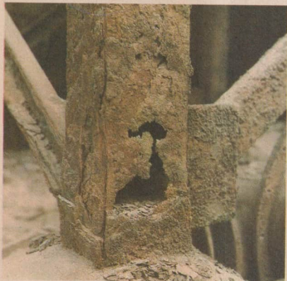
58/1 Vom Rost zerstörter Stahlträger
