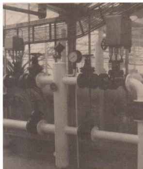
97/3 Regeleinrichtung des Gewächshauses zur Regelung der Lufttemperatur
