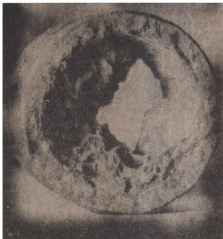
Bild 2. Rostbildung durch aggressives Wasser. Gußeisernes Rohr, Durchmesser 120 mm
