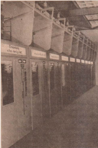
44/1 Blick in eine Innenraumschaltanlage
