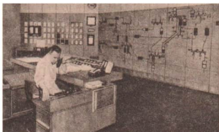
14/1 Schaltwarte im Internationalen Dispatcherszentrum des Energieverbundnetzes der sozialistischen Länder
