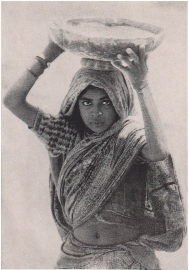
Vor der Regenzeit werden noch einmal die Dächer repariert. Die Hilfsarbeiten beim Dachdecken werden von Frauen durchgeführt
