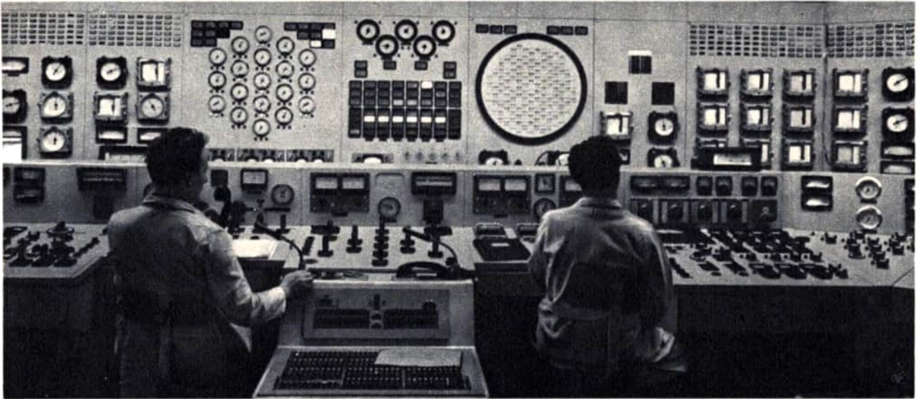
17 Blick in die Blockwarte des Atomkraftwerkes Rheinsberg. Die Blockwarte ist das „Gehirn“ des Kernkraftwerkes. Von hier aus werden insbesondere der Reaktor mit seinen Anlagen und das Aggregat gesteuert.
