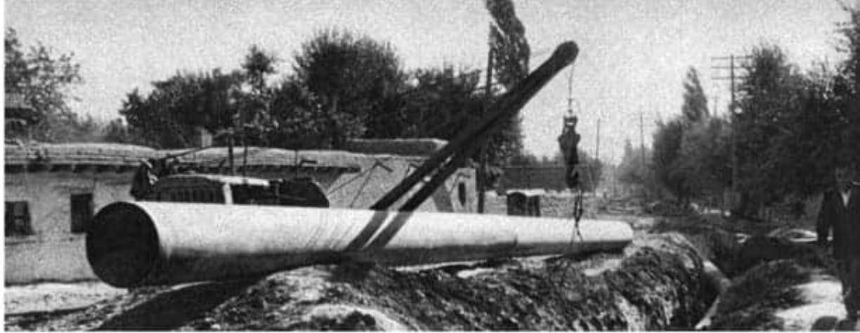
Diese Erdgasleitung wird Samarkand mit riesigen Lagerstätten 300 km westlich der Stadt verbinden
