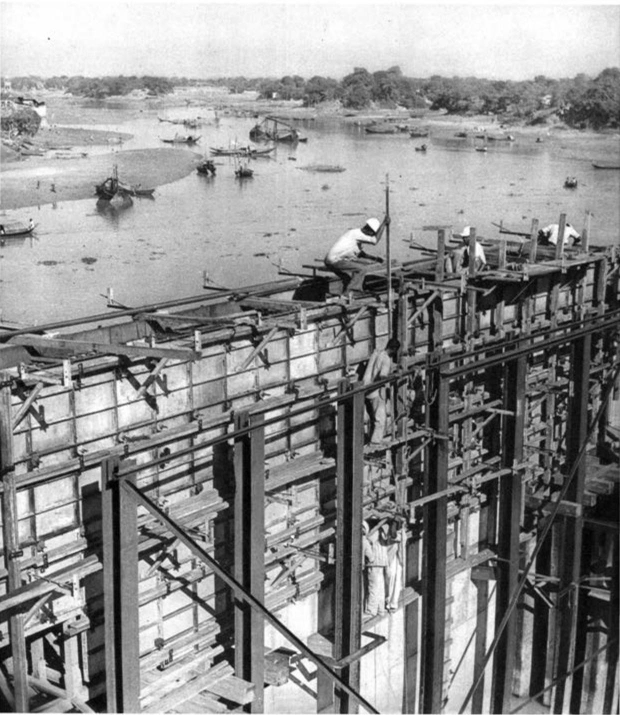
Bei Mirpur wird eine Brücke errichtet – ein für das ganze Land charakteristisches Bild
