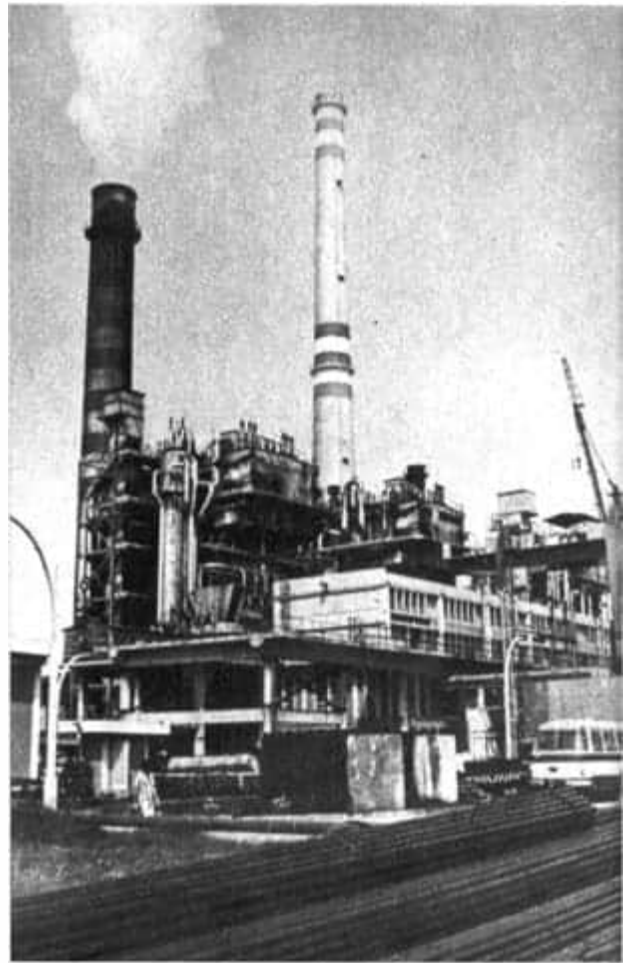
Teilansicht des Wärmekraftwerkes in Nuevitas, dem bedeutenden Industriezentrum in der Provinz Camaguey
