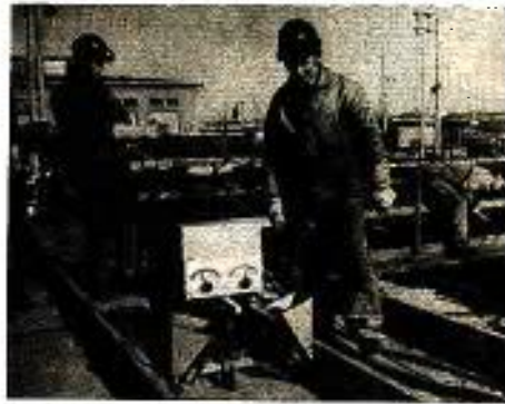
Bild 63/2 Lichtbogenschweißanlage im Schiffsbau
