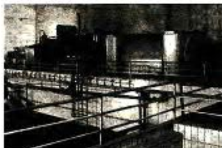
Bild 39/3 Blockeinheit Turbine-Generator in einem Wärme kraftwerk
